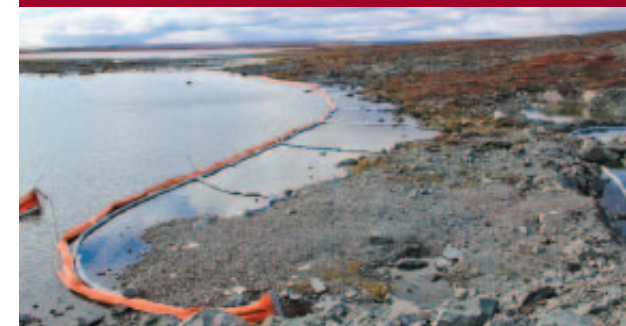
Nettoyage du déversement de carburant sur la route d'accès Photo : Sophia Granchinho, 2011
